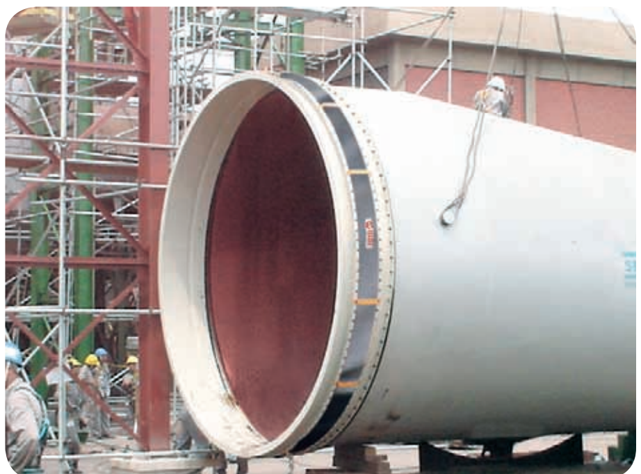
Junta de Expansão instalada em Indústria do Segmento Siderúrgico
